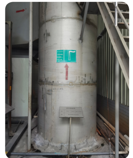
废气处理设施
